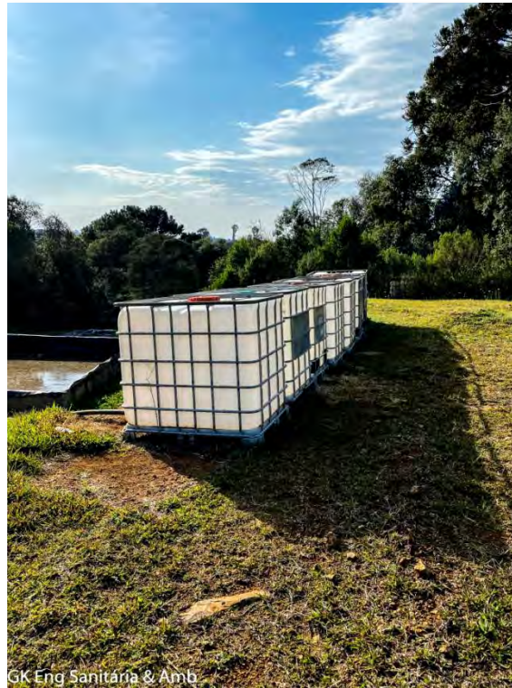
Figura 41 - Tanques de acumulação do sulfato de alumínio utilizado na ETE. Fonte: GK ENGENHARIA, levantamento de campo.
