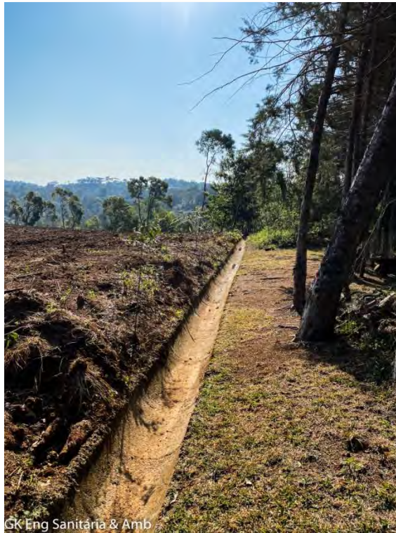
Figura 26 - Drenagem perimetral construída com meia cana de concreto na divisa noroeste do terreno. Fonte: GK ENGENHARIA, levantamento de campo.
