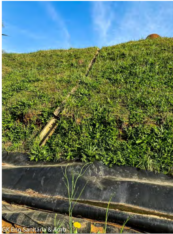
Figura 24 - Padrão de drenagem de águas pluviais sobre a superfície dos taludes do patamar basal do maciço de resíduos sólidos composta por canaletas meia cana de concreto rejuntadas. Fonte: GK ENGENHARIA, levantamento de campo.
