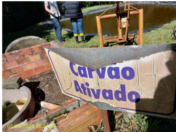
Foto 12 - Filtros de carvão ativado
