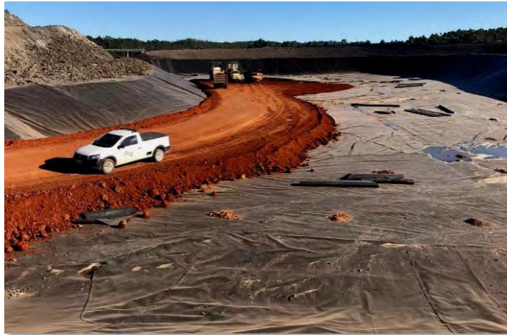
Foto 10 - Exemplo de como deverá ocorrer a disposição da camada de argila C2 sobre a geomembrana.
