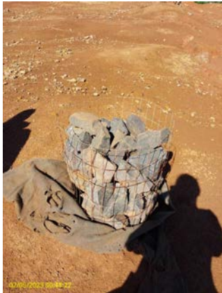
Foto 1 - Dreno de gases
