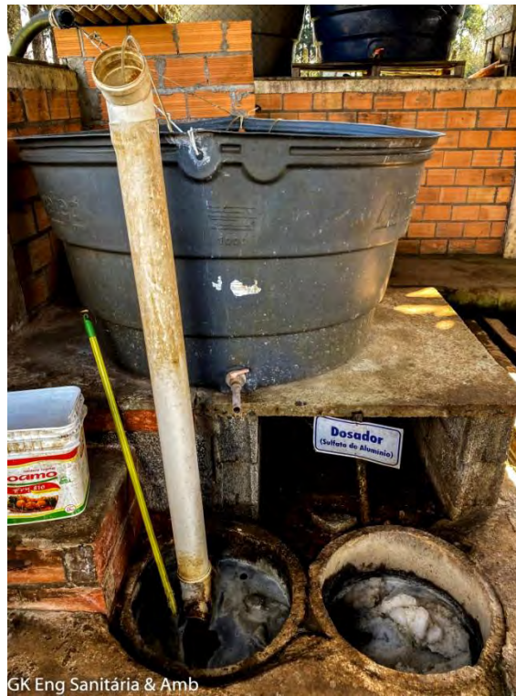
Figura 43 - Dosador de sulfato de alumínio. Fonte: GK ENGENHARIA, levantamento de campo.
