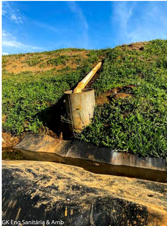
Figura 31 - Outro dreno que coleta os líquidos gerados na porção interna do maciço e conduz para o dreno perimetral à célula 0. Fonte: GK ENGENHARIA, levantamento de campo.
