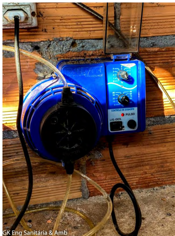
Figura 44 - Detalhe da bomba de dosagem de sulfato de alumínio. Fonte: GK ENGENHARIA, levantamento de campo.
