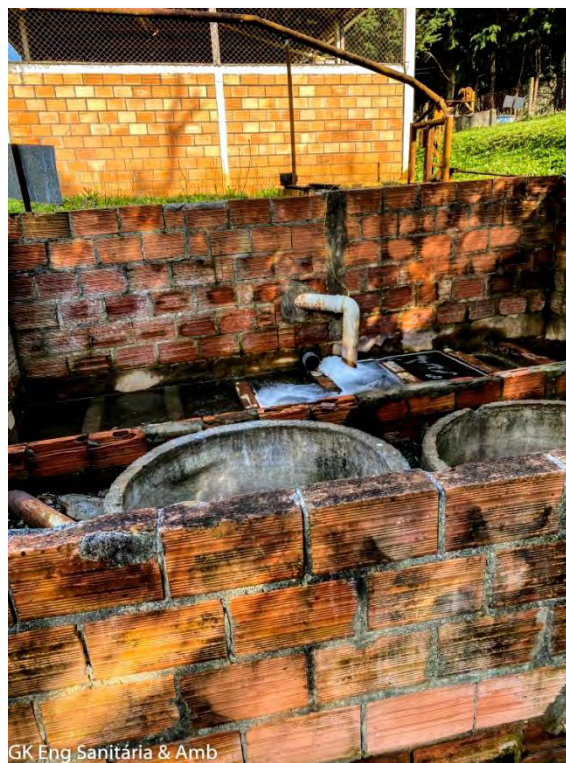
Figura 48 - Ponto de saída do efluente do flocculador e entrada no módulo de carvão ativado. Fonte: GK ENGENHARIA, levantamento de campo.
