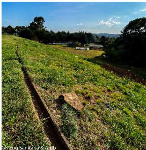
Figura 25 - Drenagem de pluviais situada na base de talude da célula 0, já encerrada, de disposição de resíduos. Fonte: GK ENGENHARIA, levantamento de campo.
