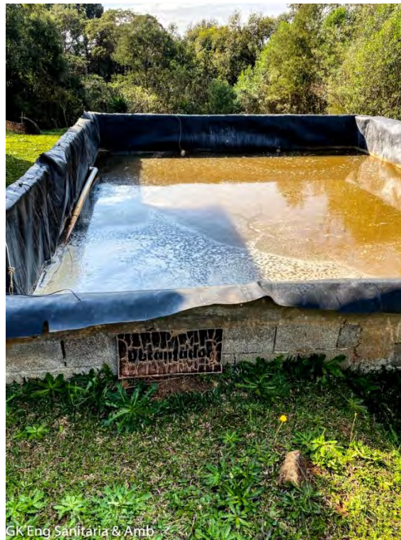
Figura 47 - Módulo decantador da ETE. Fonte: GK ENGENHARIA, levantamento de campo.
