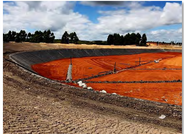
Foto 16 - Sistema de drenagem horizontal de chorume com formato “espinha de peixe”.
