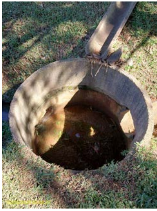
Foto 5 - Sistema de drenagem de água superficial
