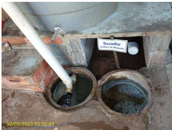
Foto 3 - Dosador de sulfato de alumínio
