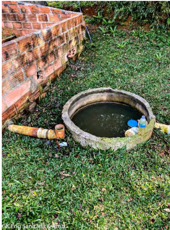
Figura 51 - Ponto de inspeção após o módulo de passagem no carvão ativado. Fonte: GK ENGENHARIA, levantamento de campo.
