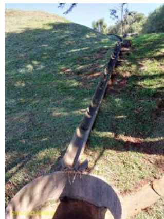
Foto 4 - Drenagem de água superficial
