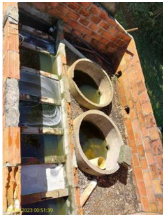
Foto 11 - Filtros de carvão ativado
