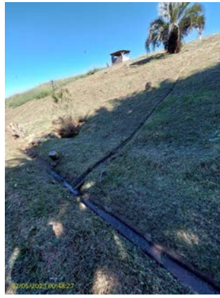
Foto 6 - Sistema de drenagem de água superficial
