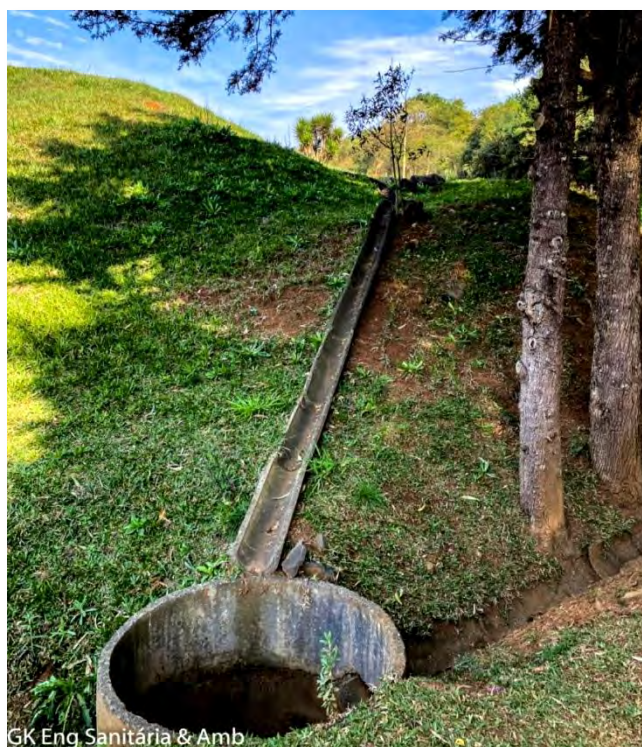
Figura 105 - Drenagem perimetral já implantada na borda da célula encerrada do aterro sanitário e cujo padrão construtivo será mantido na célula 2. Fonte: GK ENGENHARIA, agosto 2022.
