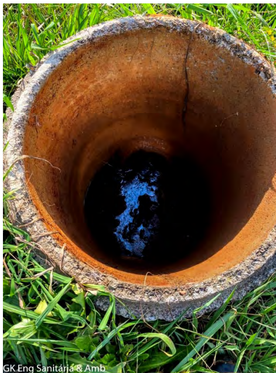
Figura 32 - Poço de visita para inspeção visual do dreno perimetral de percolados. Fonte: GK ENGENHARIA, levantamento de campo.
