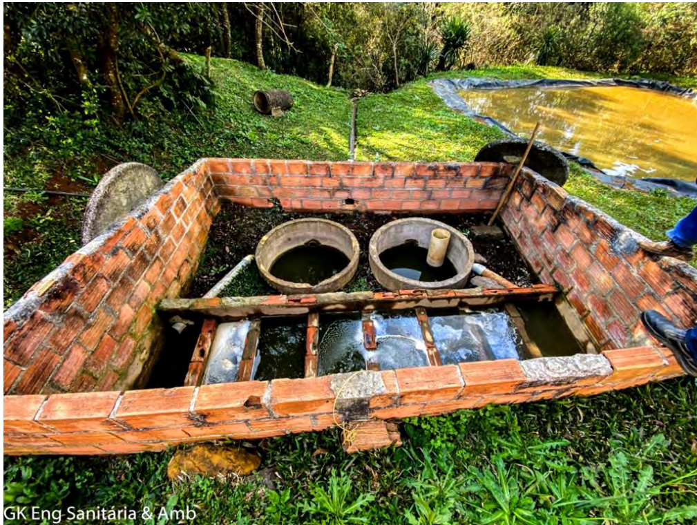
Figura 49 - Módulo de passagem para tratamento com carvão ativado. Fonte: GK ENGENHARIA, levantamento de campo.
