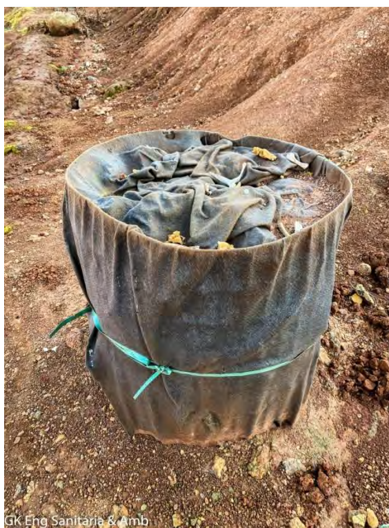
Figura 34 - Detalhe de dreno de gases instalado na base da célula 1. Fonte: GK ENGENHARIA, levantamento de campo.
