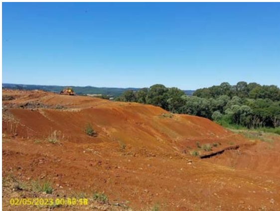
Foto 3 - Ausência de gramíneas no talude
