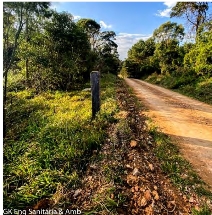
Figura 15 - Borda sudoeste do terreno onde há apenas os mourões implantados, sem o devido cercamento perimetral. Fonte: GK ENGENHARIA, levantamento de campo.
