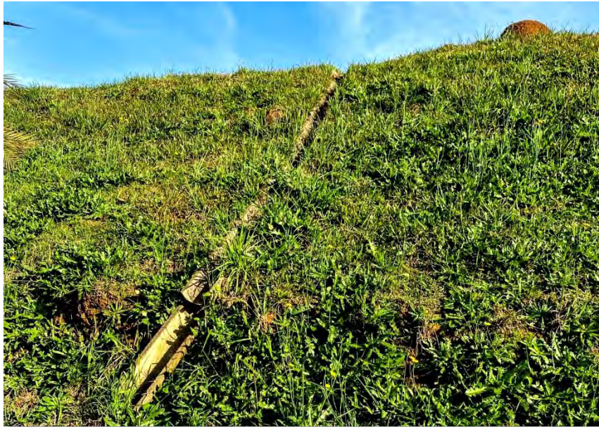
Figura 103 - Drenagem de talude composta por meia cana de concreto já implantada no aterro sanitário. Fonte: GK ENGENHARIA, agosto 2022.
