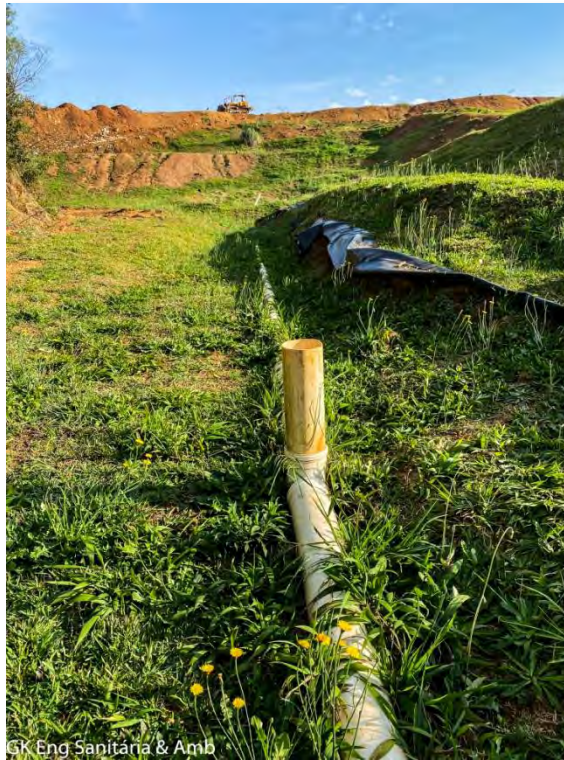
Figura 29 - Dreno perimetral de percolados que capta os líquidos conduzidos pela drenagem interna às células. Fonte: GK ENGENHARIA, levantamento de campo.
