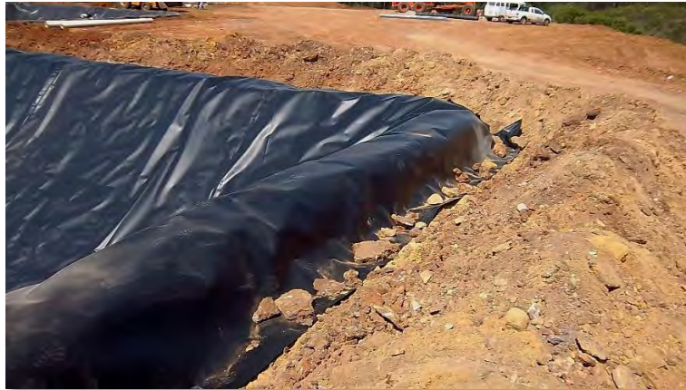
Foto 7 - Exemplo construtivo de vala perimetral e ancoragem da geomembrana realizada na borda dos taludes.
