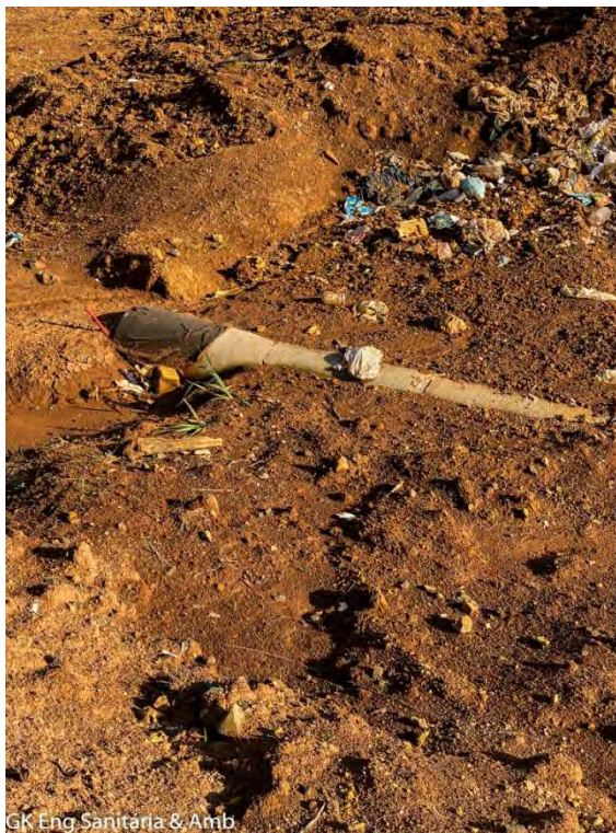
Figura 28 - Dreno de percolados que coleta e conduz os líquidos gerados na porção interna do maciço de resíduos. Fonte: GK ENGENHARIA, levantamento de campo.
