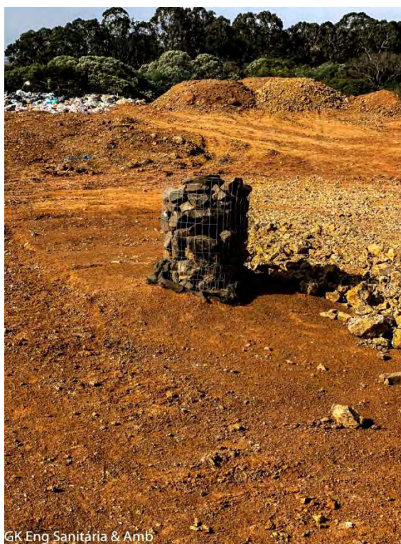
Figura 36 - Outro dreno de gás instalado no topo da célula 1. Fonte: GK ENGENHARIA, levantamento de campo.
