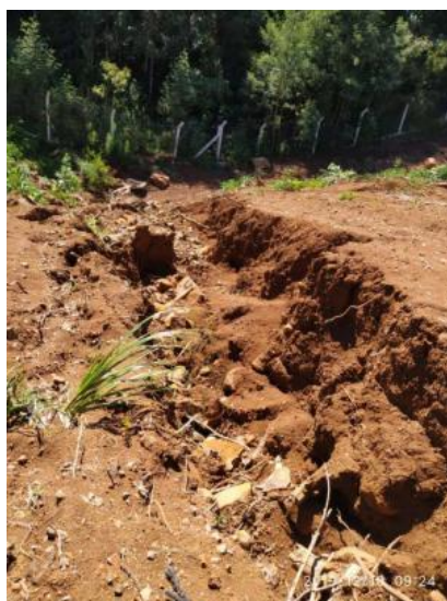
Figura 6.3 - Detalhe da vala de erosão formada ao longo da saia do aterro da PPD
