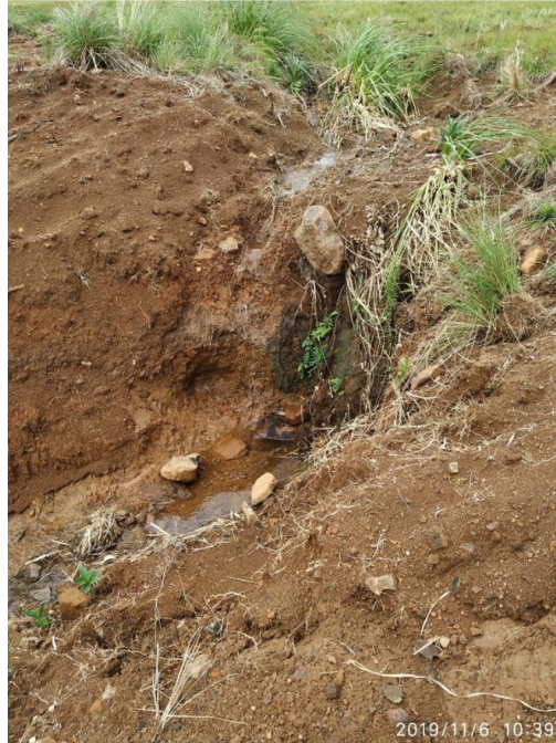
Figura 0-1 - Erosão em aterro lançado
