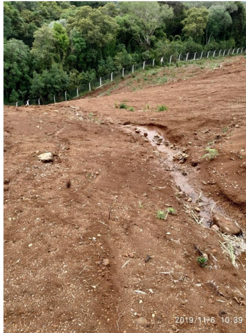
Figura 0-5 – Desnível bastante acentuado a ser corrigido com o aumento da faixa preparada. Ao fundo pode ser observada a cerca patrimonial, fragmento de mata nativa e curso d'água (este último não visível).
