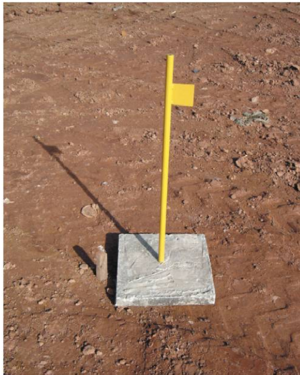
Figura 1 - Marcos superficiais: medidor de recalque de base quadrada
